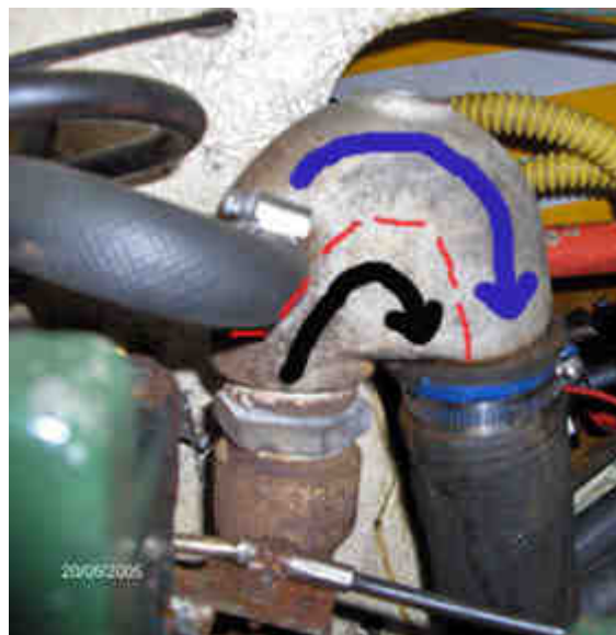
Durite sortie calorstat -> pipe d'échappement (photo 1)
